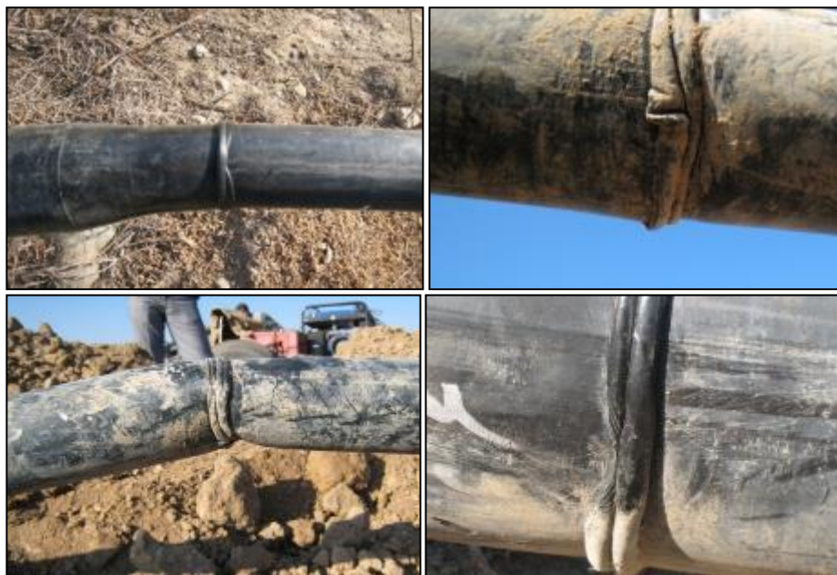
شکل ۶-۱۲- نمونه‌هایی از جوش‌های نامناسب
