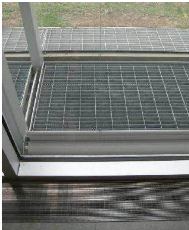
شکل ۸-۳-۲۳. ورودی هوای نمای دوپوسته، در سطح ترانشه طبقه اول، کرکره‌های فلزی کنترل‌شده توسط محرک در زیر رنده فلزی در راستای دیوار تیغهای بیرونی قرار دارند. منبع: ماری بن بونهام.
