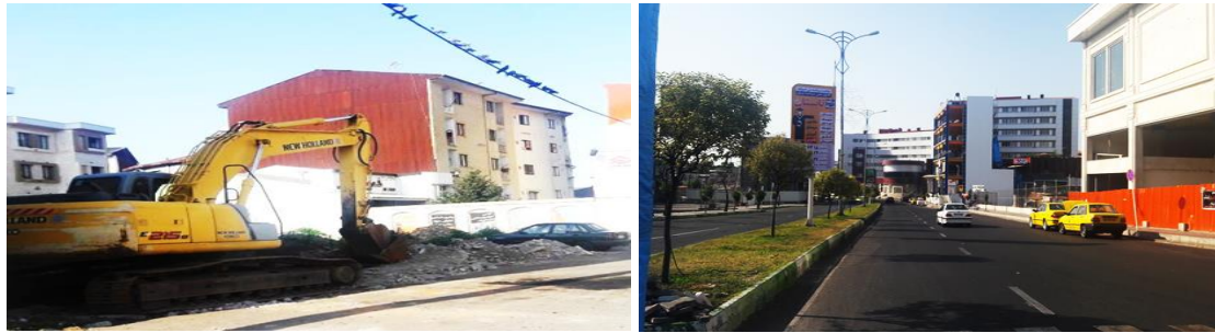
شکل ۱۰. خیابان سرخبنده بعد از بازسازی و ایجاد سازه‌های تجاری-اداری (سمت)، عملیات تخریب بافت‌های فرسوده در طرح محور تختی-صیقلان (سمت چپ)
