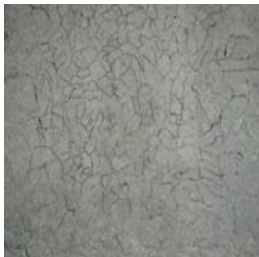
شکل ۹- ترک‌های ایجاد شده در اثر اعمال حرارت
